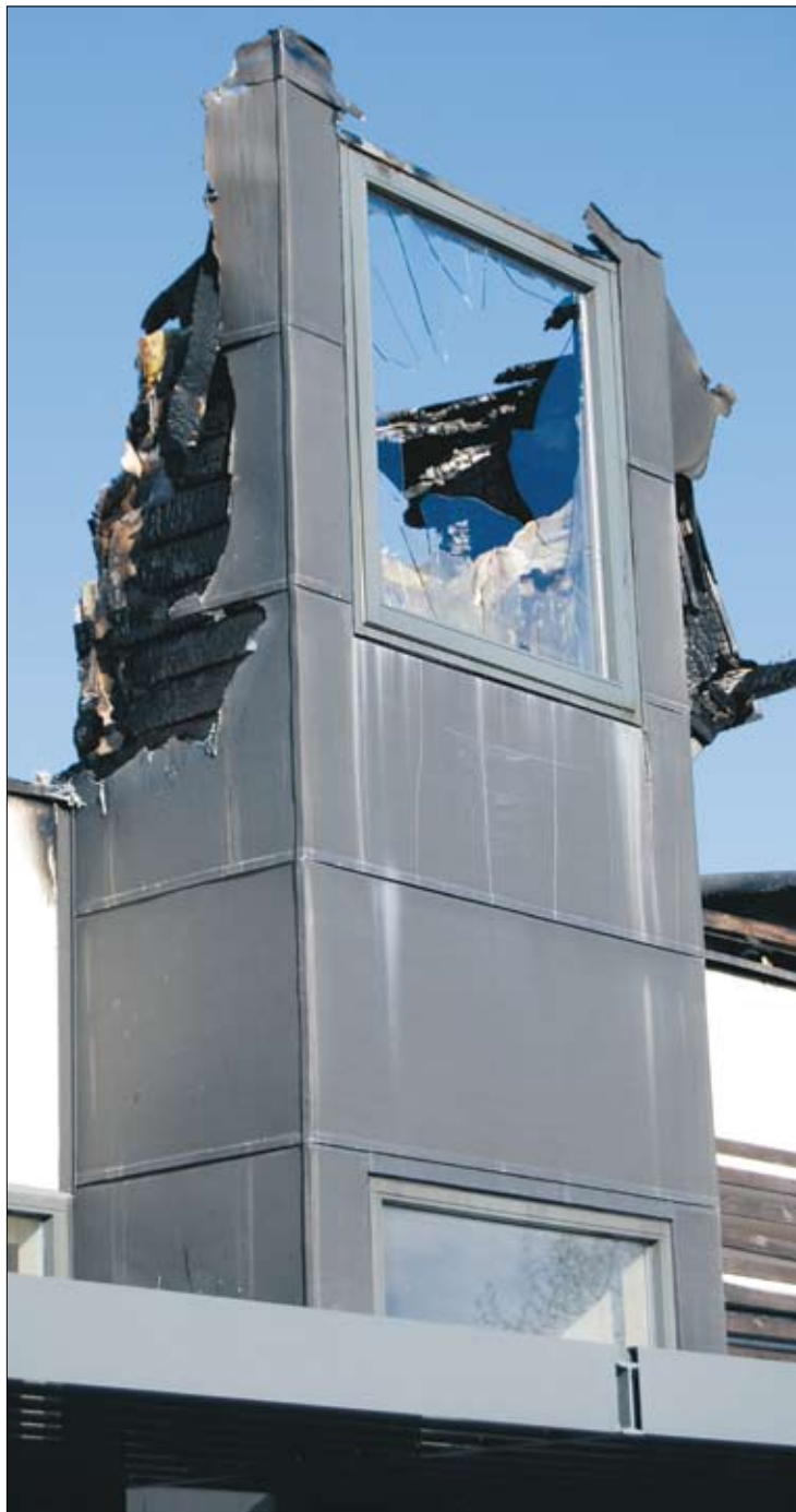
Ødelæggelser på Værebroskole i Bagsværd. Et tagvindue står frit tilbage, efter at skolens tag er blevet opslugt i den påsatte brand.
